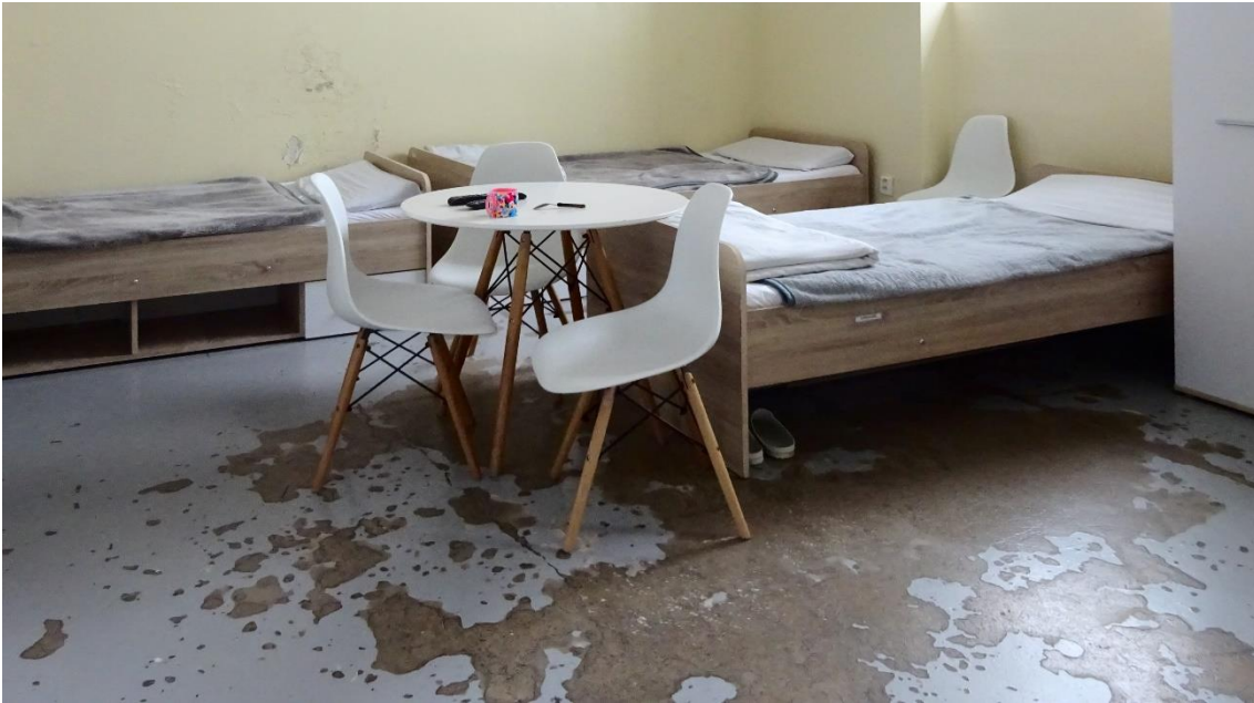
Foto č. 4: Poškozená podlaha na ložnici výstupního oddílu.
