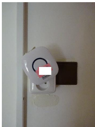
Obr. 9 – Přenosná signalizace na chodbě
