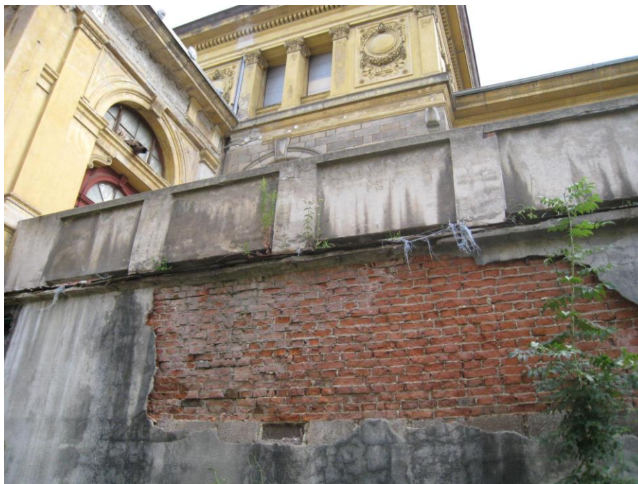
Obrázek č. 3 - objekt nádražní budovy, zatékáním poškozená část uliční fasády.
