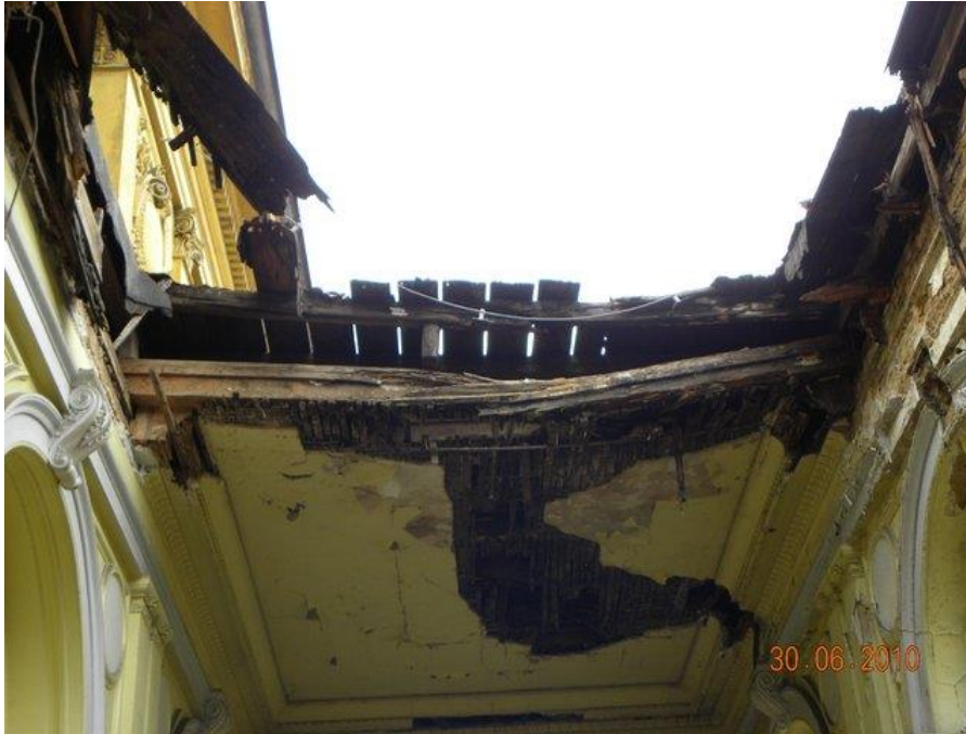
Obrázek č. 2 - propadlá střecha vstupní části nádražní budovy v důsledku dlouhodobého zatékání.
