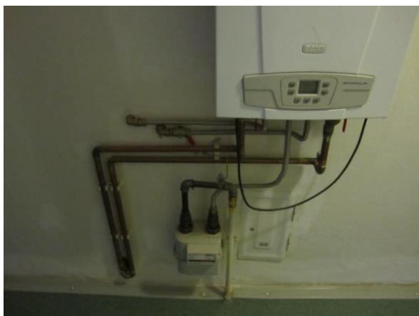
Plynový kotel na chodbě
